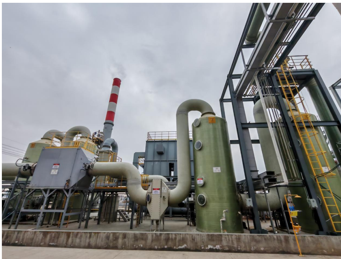
RTO 焚烧装置设施
