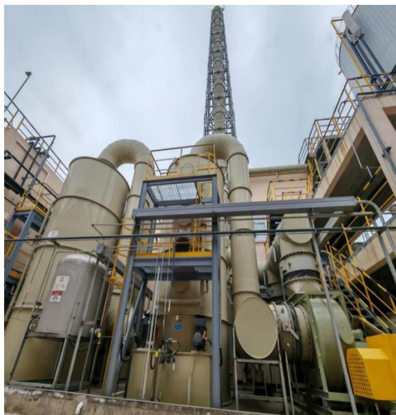
污水站低浓度废气处理设施
