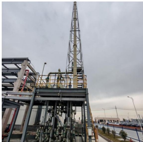
储罐区酸性废气处理设施
