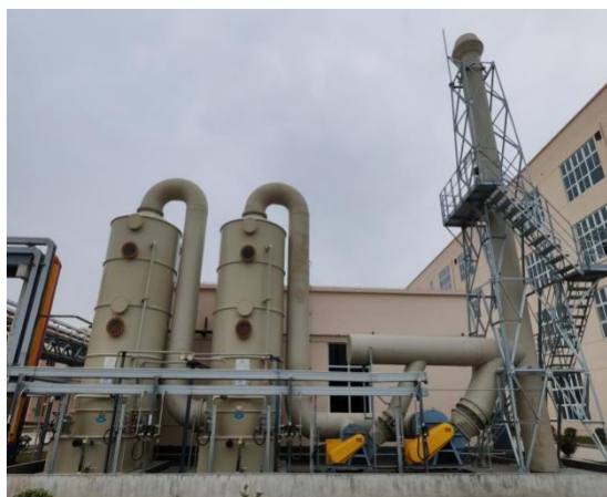
甲类仓库废气处理设施
