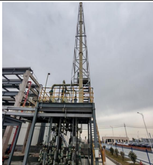
储罐区酸性废气处理设施
