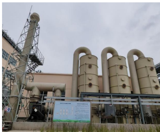
危废仓库废气处理设施
