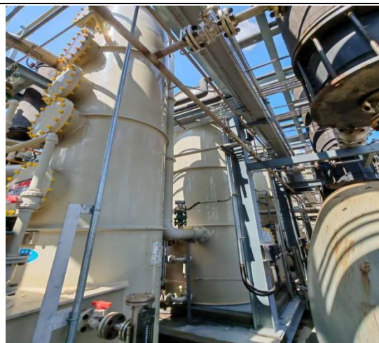
生产车间十二废气预处理设施
