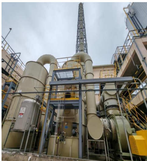
污水站低浓度废气处理设施
